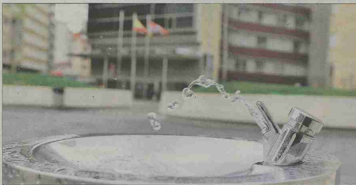
Fuente del Rincón de Bécquer que no para de echar agua desde su inauguración. / ÁLVARO MARTÍNEZ
